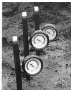
写真1 設置した状態
